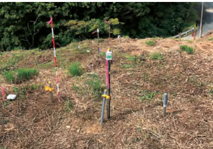
設置後の傾斜センサ
